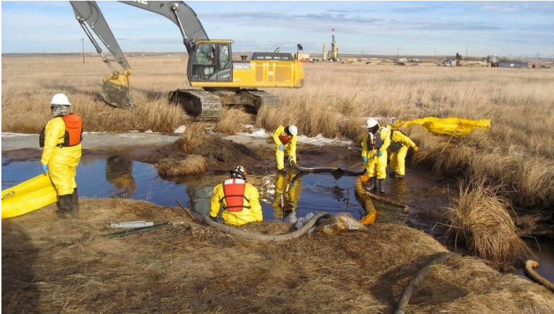
图片: 2015 年 1 月 25 号星期天, 管道泄漏将近 300 万加仑含有石油的盐水后, 工作人员开始对北达科他州威利斯北部 Blacktail 河流中回收泄漏石。图片是由环保署提供
